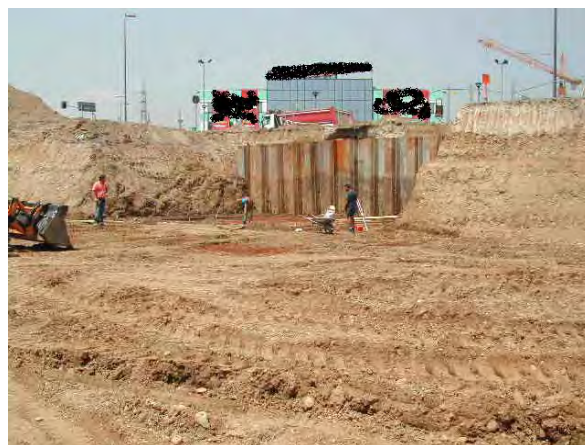
Lavori di movimentazione di TRS in un cantiere (fonte SUOS 34 Ambiente della Polizia Locale del Comune di Milano).
